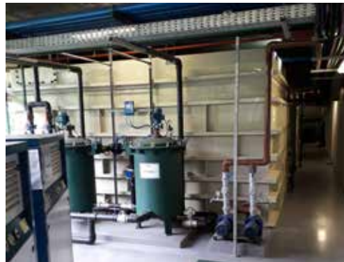
Foto 1.2. Estação de tratamento de esgoto
