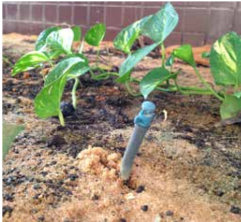
Foto 8.1. Sistema automatizado de irrigação
