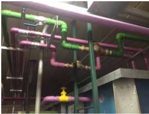
Foto 1.1. Tubulações devidamente identificadas por cores (magenta – água de reúso; verde – água potável)
