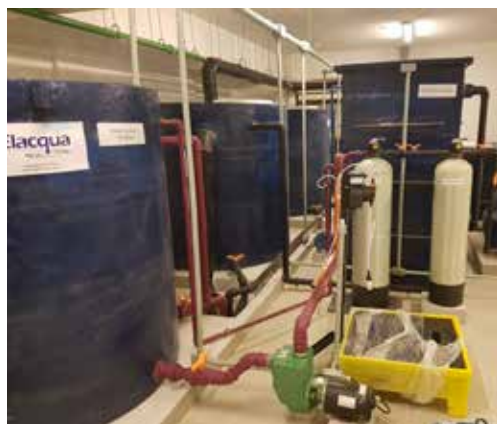
Foto 5.1. Estação de tratamento de água cinza clara (ETAC) implantada no empreendimento Vista Clementino
